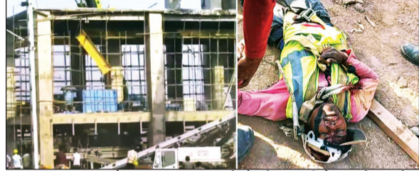
टूट गया। इस घटना के कारण श्रमिक संतुलन खोकर नीचे गिर पड़ा, जिससे उसकी घटनास्थल पर ही मौत हो गई। मृतक की पहचान लाल बहादुर पिता जयपथ उम्र 38 वर्ष निवासी बभनी जिला सोनभद्र उ.प्र. के रूप में हुई है,
