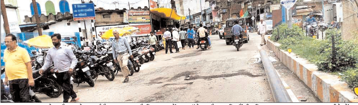
उदाहरण माजन मोड़ बैटन से लेकर नवजीवन बिहार-इंदिरा चौक तक की सड़क क्षतिग्रस्त हो
