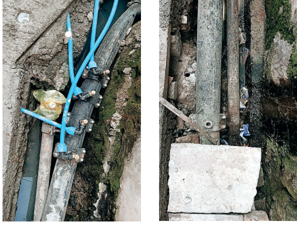
ही कोई भी पाइप लाइन नाली में डाली है। जबकि मौके पर स्थिति इसके उलट है। कंसल्टेंसी को नियुक्त किया गया है। कंसल्टेंसी के फील्ड इंजीनियर सलमान खान ने बताया नगर अभी कोई काम नहीं चल रहा है और ना
