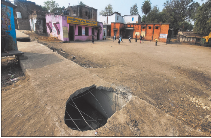
ट्रेक्टर ट्रॉली निकाले गए तो ट्रॉली का पहिया नाली के स्लैब में टूटने से धंस गया, बाहर निकाला। वहीं चार दिन पहले जब दूसरी ओर से ट्रॉली निकाली गई तो यहां भी स्लैब टूटकर अंदर घुस गया और ट्रॉली
