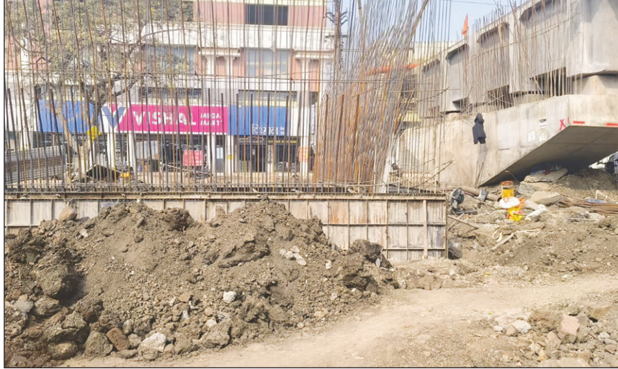
सीहोर. हाउसिंग बोर्ड कॉलोनी के समीप बन रहे ओवर ब्रिज निर्माण के चलते पेयजल लाइन व सीवेज लाइन क्षतिग्रस्त हो गई है.
