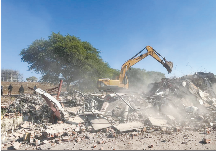
पति अलीम खान निवासी वार्ड नंबर 10 संजय स्टेडियम के पीछे अशोकनगर द्वारा ग्राम पंचायत से अनुमति लिये बिना एवं लोक निर्माण विभाग के निधारित मानकों
